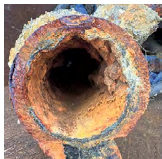
Veraltete Leitungen zwingen Verbände zu teuren Erneuerungen.
