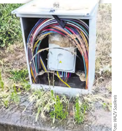
Im Saalkreis wurde ein Verteilerschrank direkt auf eine Trinkwasserleitung gesetzt. Das Ergebnis war ein Rohrbruch.
